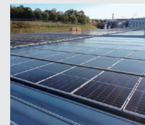
三田工場の太陽光パネル
