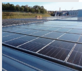
三田工場の太陽光パネル
